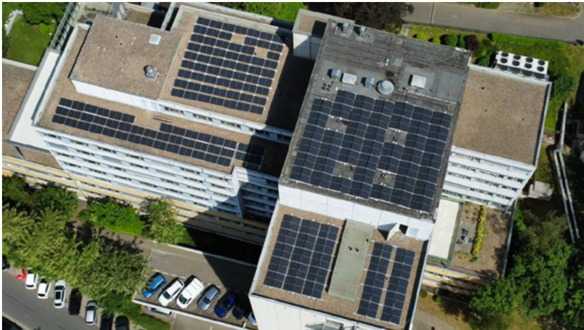
Bild 31 – Photovoltaik-Anlage des LVR Klinikums Essen
